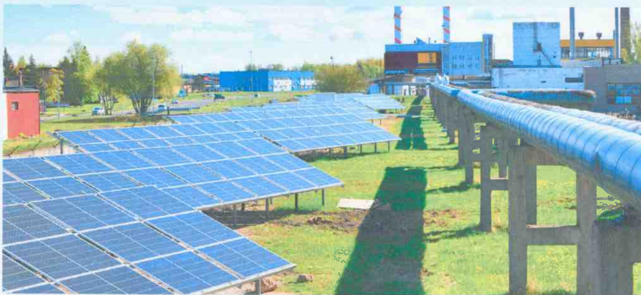
Saulės fotovoltinė elektrinė (249 kW galios) Panevėžys
