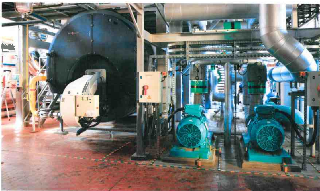
13,1 MW galios katilas, Panevėžio elektrinės katilinė
