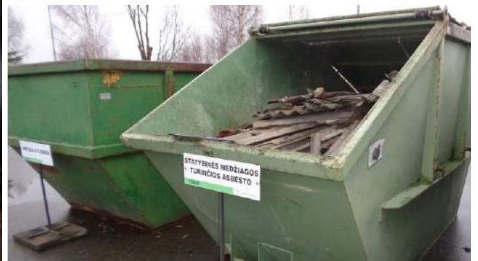
10 pav. Statybinių medžiagų, turinčių asbesto atliekos
